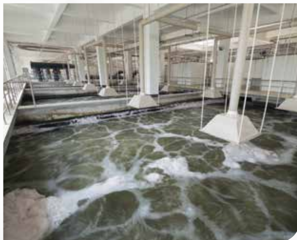
滤池顶部的处理后的污水
