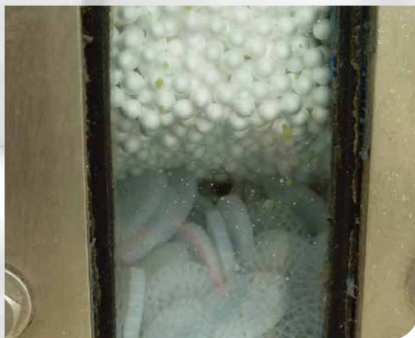
BIOSTYR® 生物滤池中的双层滤料
